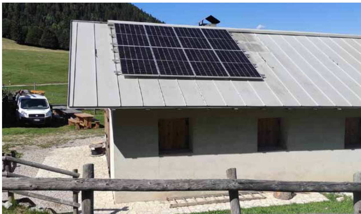
Nuovi pannelli fotovoltaici a malga Arza
